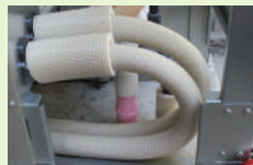
貯湯タンクユニット下
