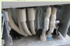
貯湯タンクユニット下
