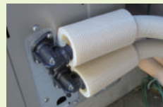
ヒートポンプ接続部
