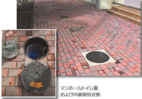
マンホールトイレ蓋 および内蓋開放状態
