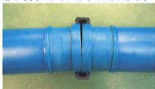
悪い例 (パッキンがずれています)
