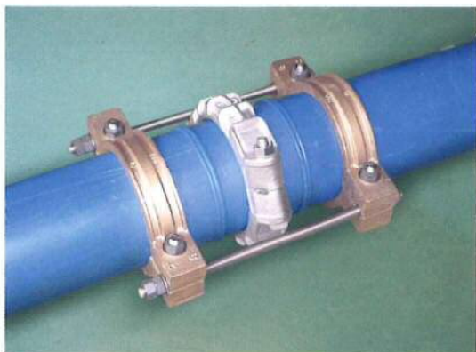
PEパイプ×PEパイプの接続部
