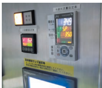
制御盤パネル面
