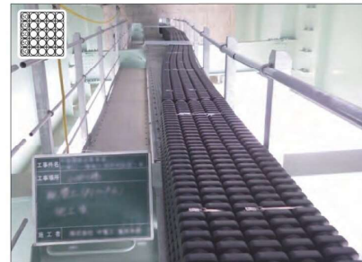
●橋梁桁内 多条配管
