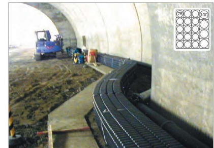
●トンネル内多条配管
